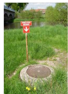
Puisard alimenté par une ressource inépuisable
