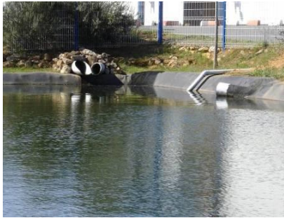
Exemple d'une réserve incendie alimentée par recueil d'eau de pluie
